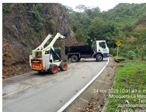
Foto 18: Remoción de derrumbes Tabacal – La Sierra.
