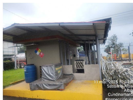
Foto 93: Cubierta plantas eléctricas.
